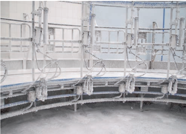
Abb. 24: Reinigungs- und Desinfektionsmittel werden am besten als Schaum aufgebracht. Dies gibt einen optischen Überblick, wo das Produkt hingekommen ist. (Quelle: Cid Lines)
