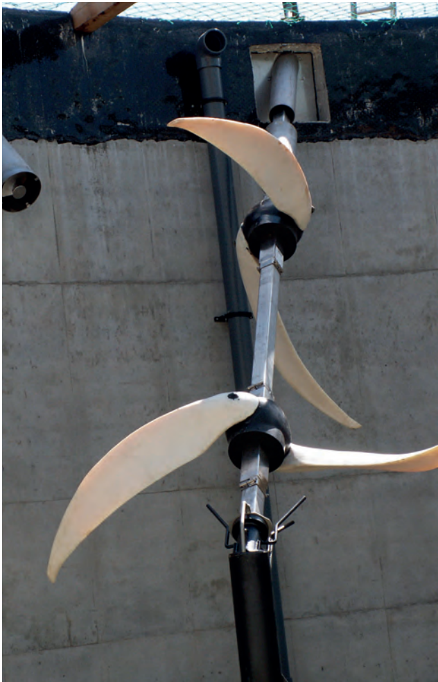
Abb. 4: Das Rührwerk der Biogasanlage arbeitet im Verborgenen
